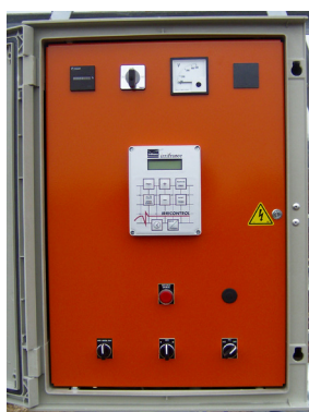
ARMOIRE PIVOCONTROL / PIVODOSEUR
