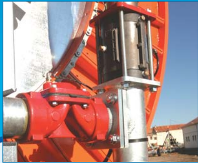
Ensemble vannes d'alimentation
